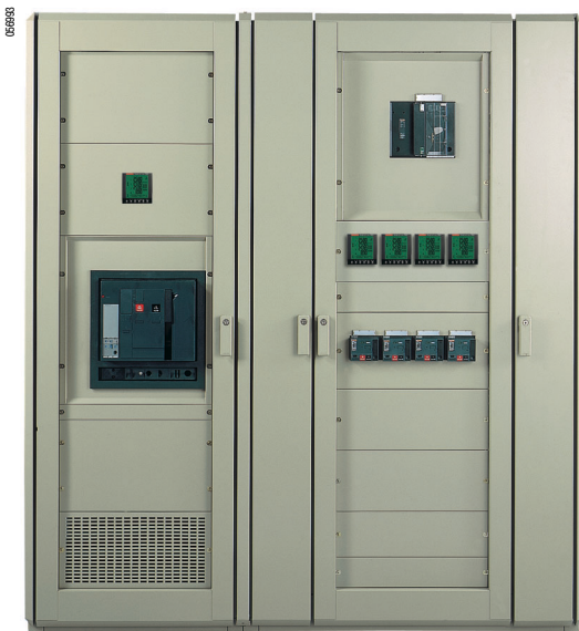
Главный распределительный щит
