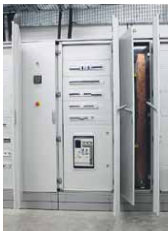
Полностью укомплектованный шкаф XL 3 4000
