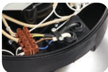
Подвод питания для рабочей и аварийной ламп.
