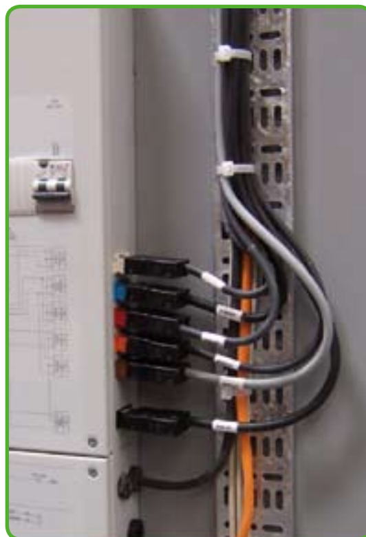
Подвод к зданиям
