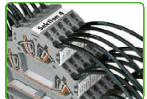
Маркировка незанятых клеммных мест с использованием мультимаркировочной системы WMB или системы быстрой маркировки WSB (см. раздел 6). Групповая маркировка маркировочными полосками 709-177.
