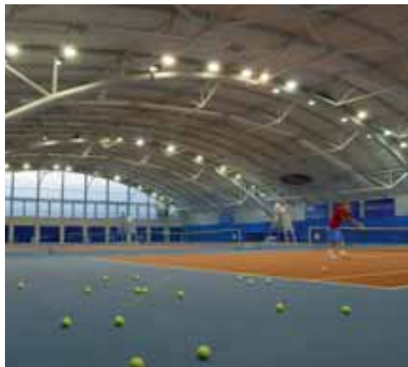
Рис. 22. Пример освещения зала с теннисными кортами.
