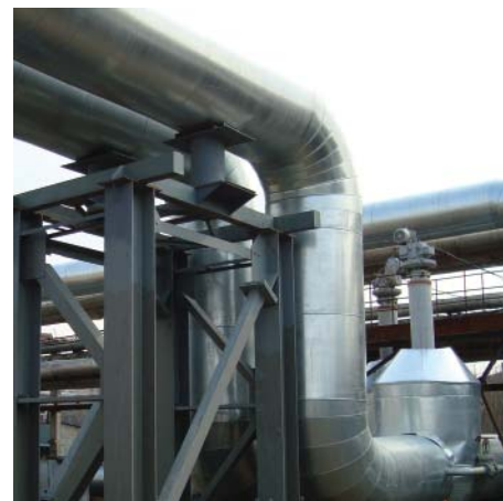
Системы вентиляции, кондиционирования и трубопроводы
