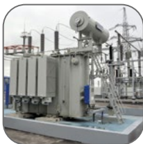
Объекты энергетической отрасли
