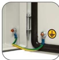
Обмедненные шпильки заземления. Закрепленный поводок заземления
