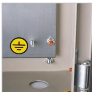
Шпилька заземления на монтажной панели.
