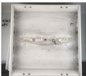
5. Вид светильника Армстронг, готового для установки светодиодных ламп SAFFIT.
