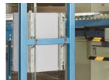
Шкаф Atlantic на горизонтальном траверсе с суппортом Кат. № 0 364 48
