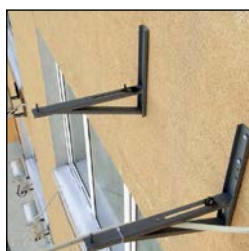
Крепление опор, держателей.
