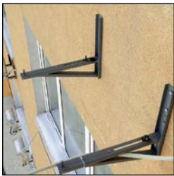
Крепление опор, держателей.
