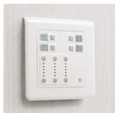
Контроллер управления освещением
